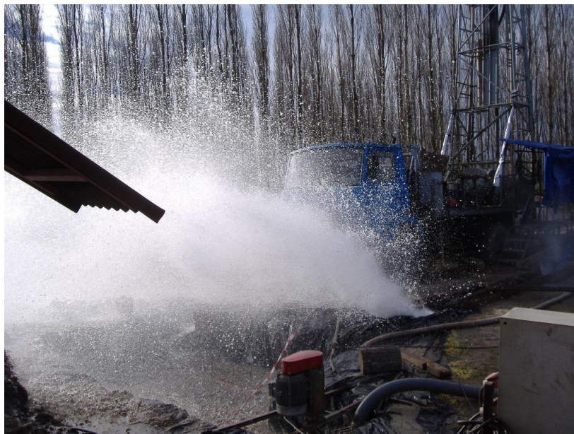
Az Emese kút kompresszorindítás után
