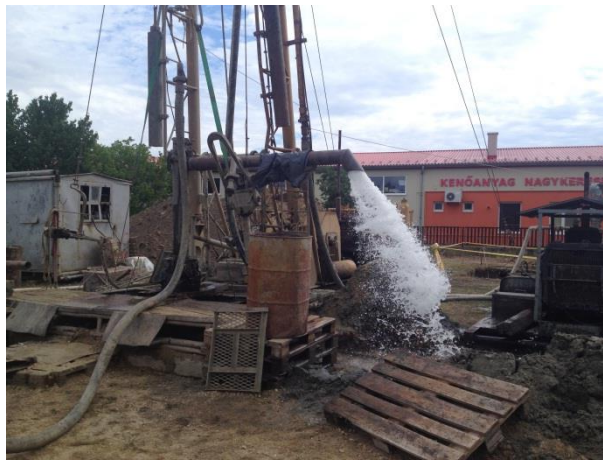
2. kép. A kút kompresszorozás közben 1500 l/perc vízhozamot ad
