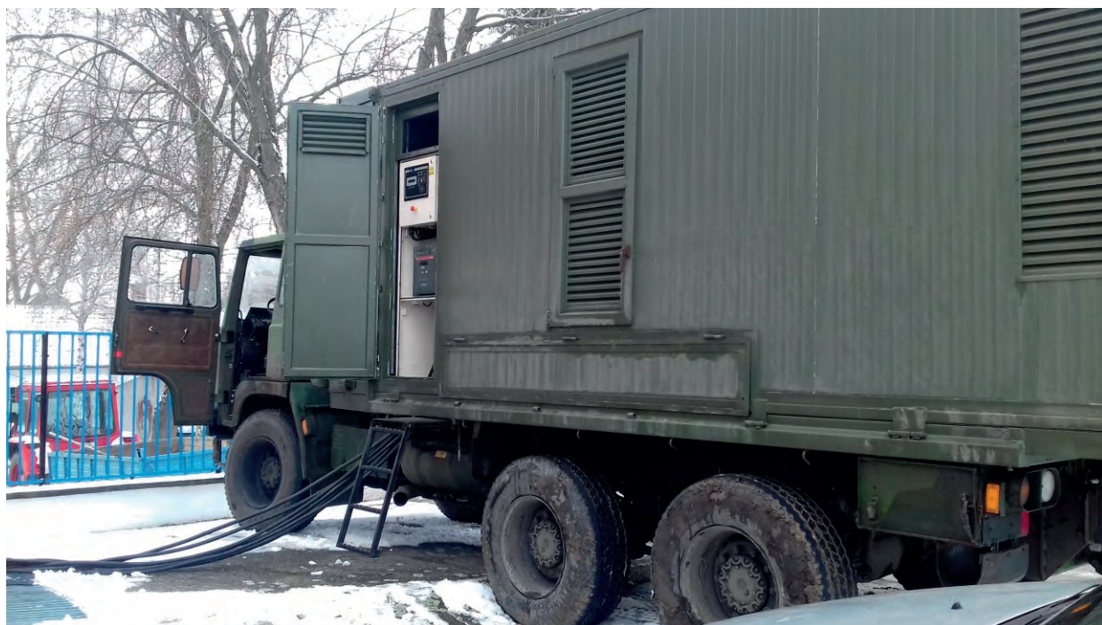
34. kép Nagyteljesítményű aggregátorok a Villogói és a Mirhói szivattyútelepeken
