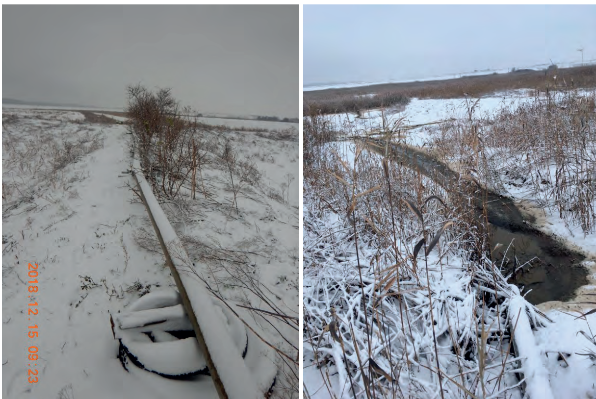
48. kép Illegálisan kiépített csővezeték, és bevezetés a Kékes (Lapos) Morotvába
