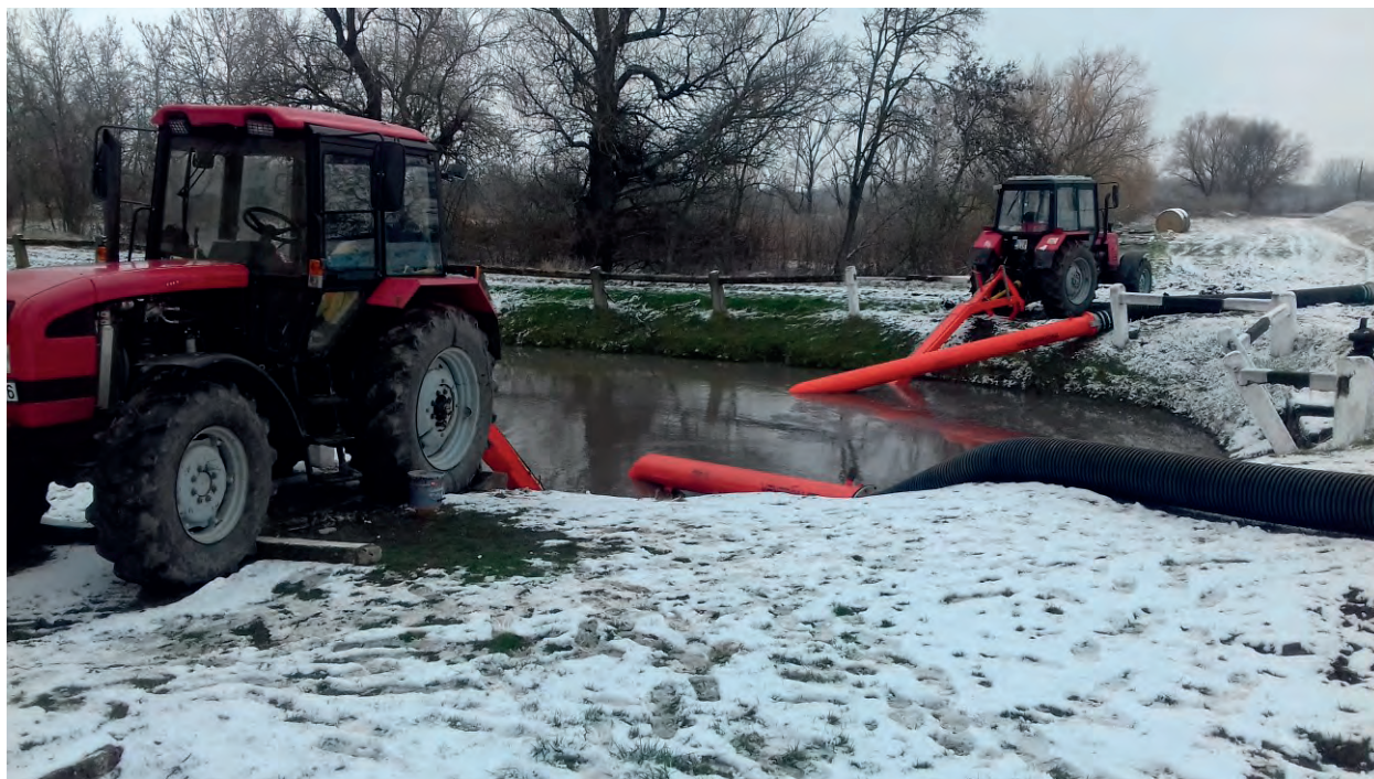
32. kép Veneroni szivattyúval történt felvonulás a Mirhó szivattyútelepnél
