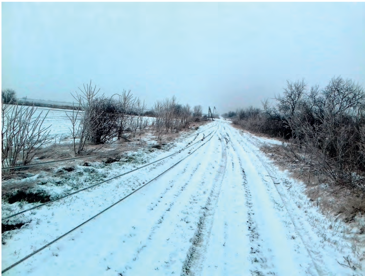
31. kép A 10.08. Karcagi belvízvédelmi szakaszon megrongálódott vezetékhalózat
