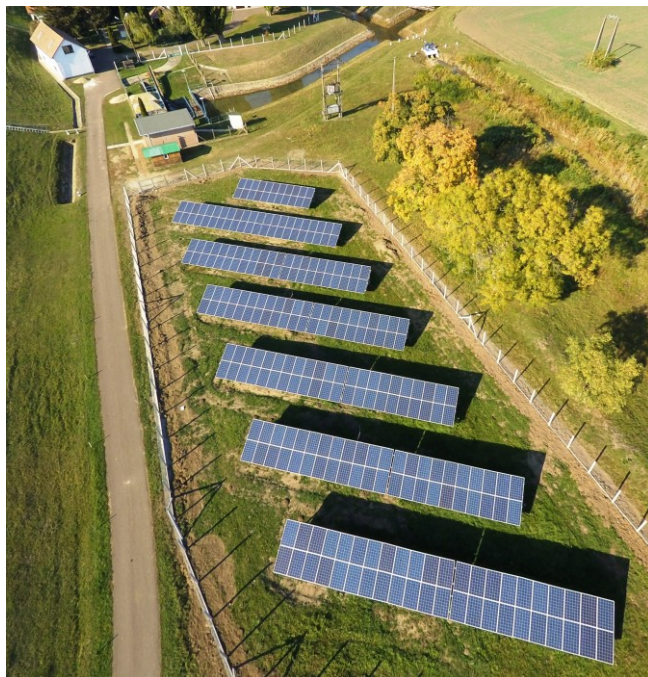
40. kép Érfüi napelempark
