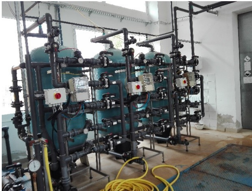
14. kép Örményes települési vízmű 3 db vas-és mangántalanító
