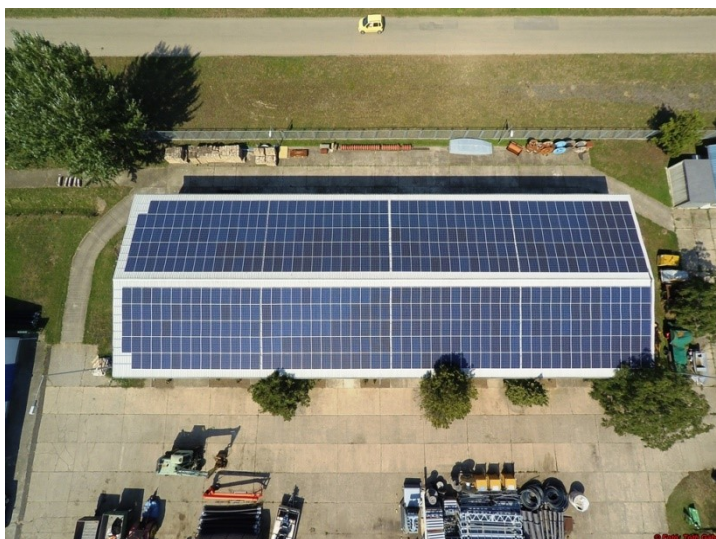
41. kép Kisköre üzemi telep naperőmű
